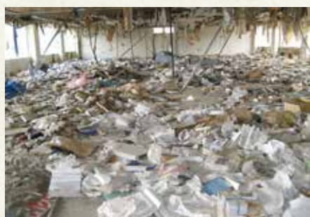
被災時の陸前高田市役所庁舎
